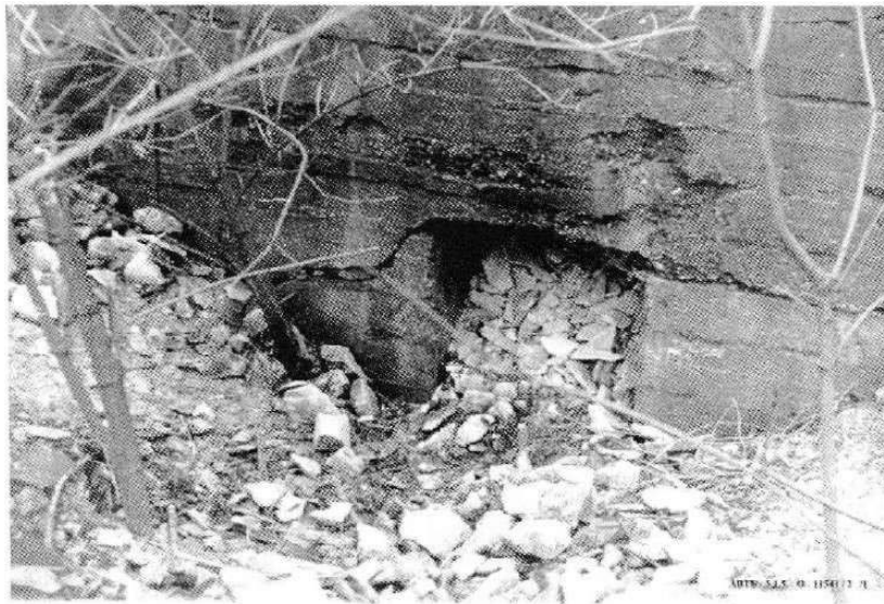
A Bérc utcai villa kertjében törmelék fedi a feltételezett titkos pincelejáratot [Debris covers the suspected secret basement entry in the garden of the Bérc Street mansion] Állambiztonsági Szolgálatok Történeti Levéltára (ÁBTL) [State Security Services History Archives (SSSHA)], 3.1.5. O-11541-2-002.
